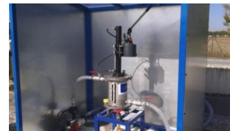
Planta piloto en EDAR Los Arcos pruebas industriales
